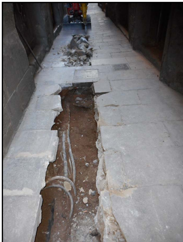
19. Treballs de buidat de la rasa al carrer de Sant Domènec del Call.
